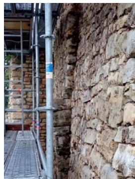
Le décrochement d'une partie du mur
